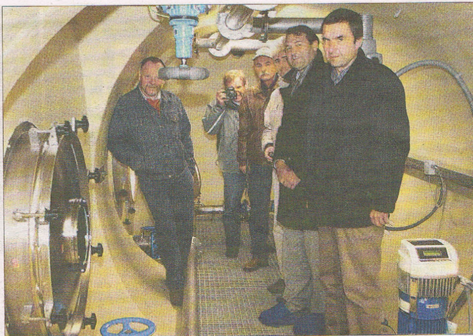
Wassermeister Josef Speiser (l.), Bürgermeister Anton Fischer und Harald Wels von der Firma Hobas (r.) mit den ungarischen Gästen im Technikraum.
